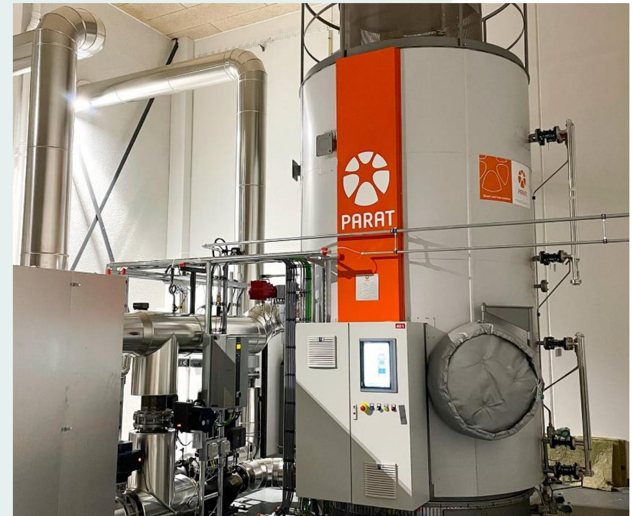
Eksempel fra Brande Fjernvarme (15 MW elkedel)
