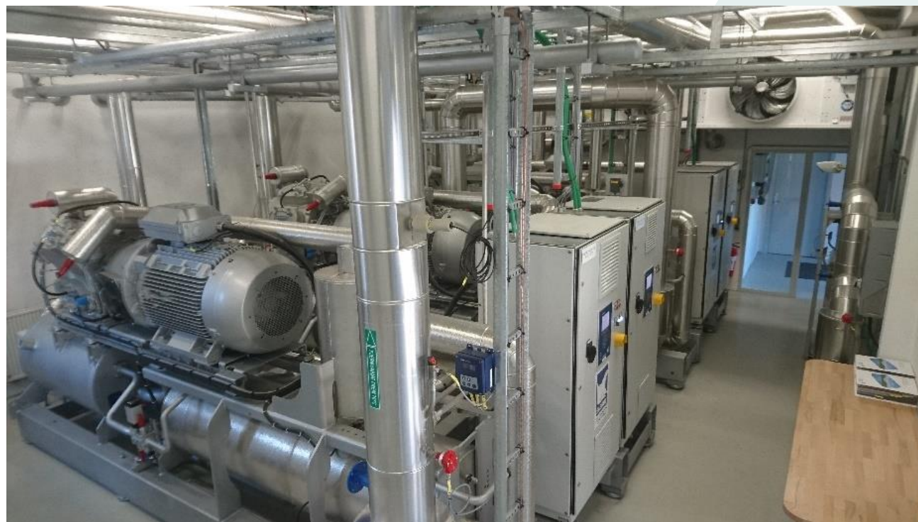
Spildevandsvarmepumpe i Rødkærsbro (1,5 MW)
