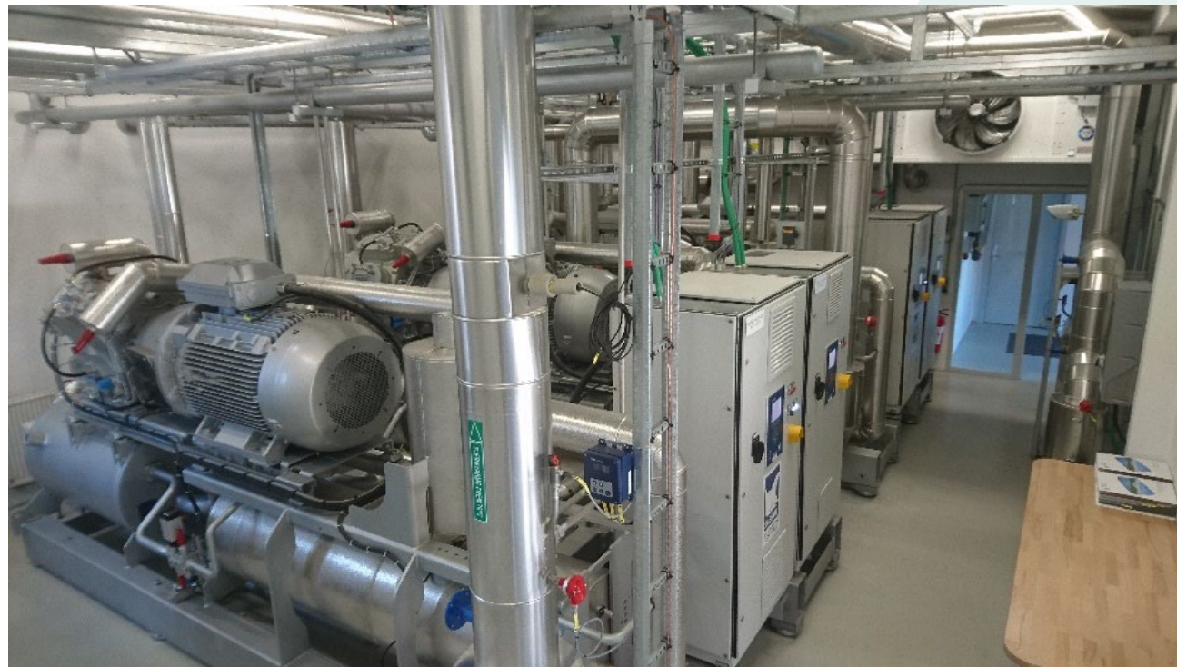
Spildevandsvarmepumpe i Rødkærsbro (1,5 MW)
