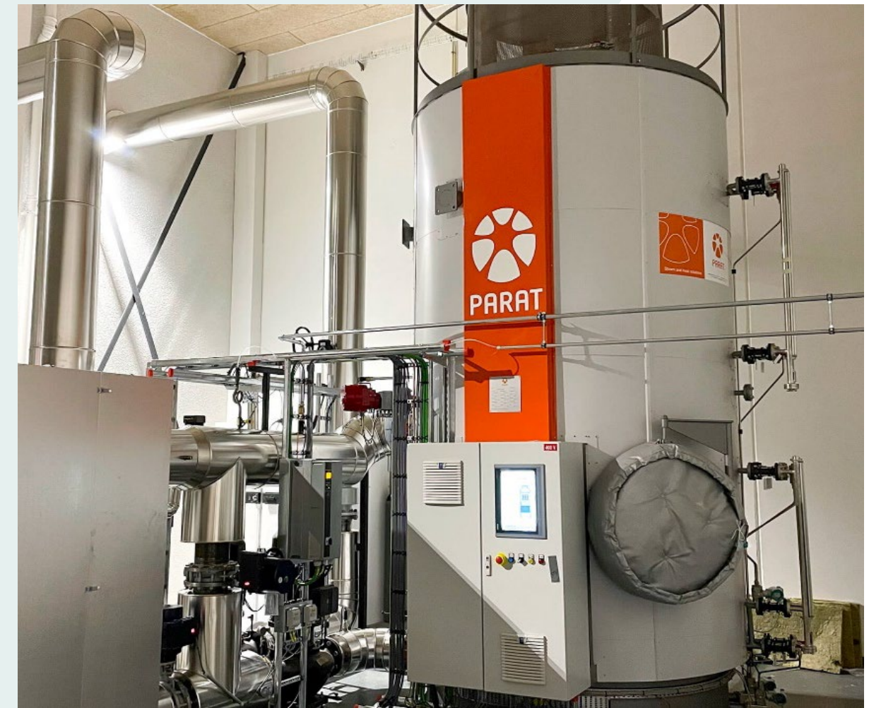
Eksempel fra Brande Fjernvarme (15 MW elkedel)
