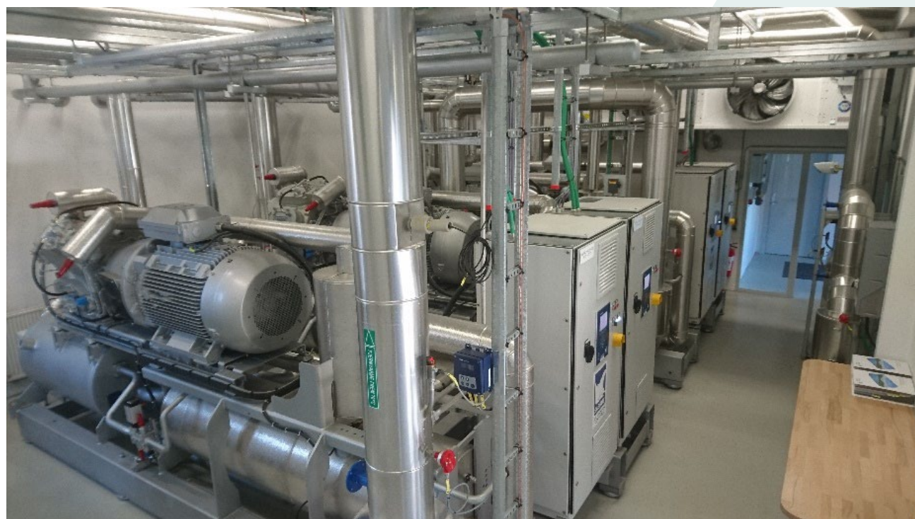
Spildevandsvarmepumpe i Rødkærsbro (1,5 MW)
